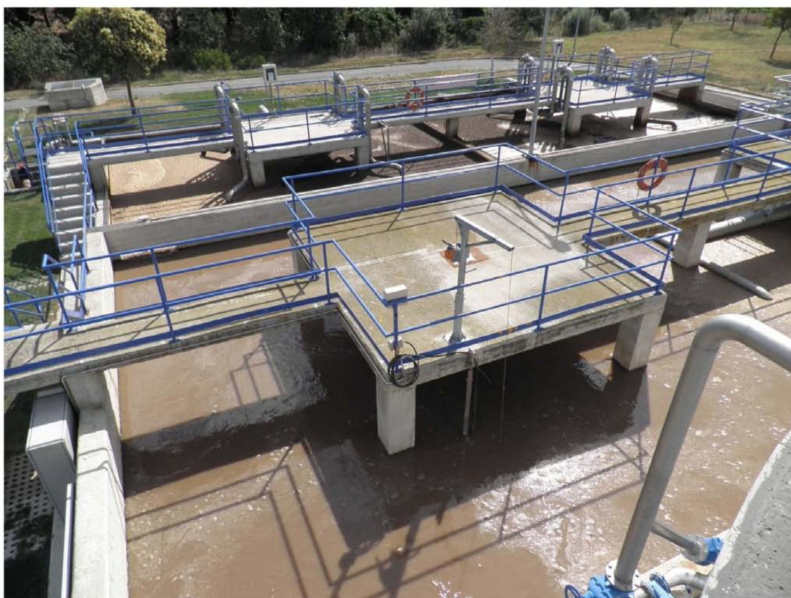
Imagen de una depuradora en España. Imagen de archivo
